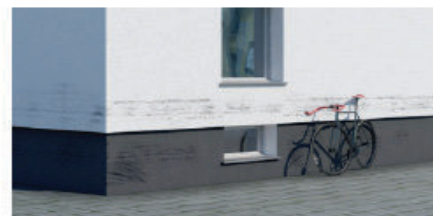
Цокълът е частта от сградата, която е изложена на най-сериозно механично натоварване
