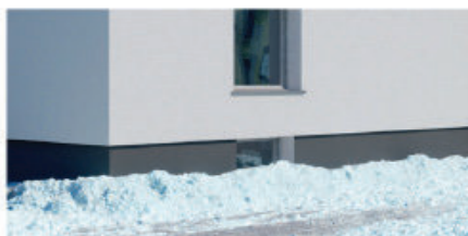
При топенето на снега зоната на цокъла е застрашена от допълнителна влажност.
