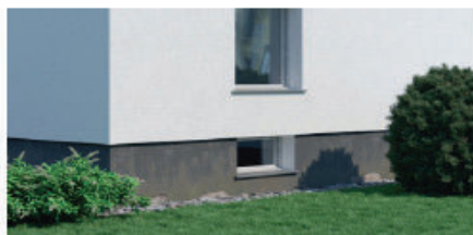
Капиллярна абсорбция на влага, причинена от температурните колебания
