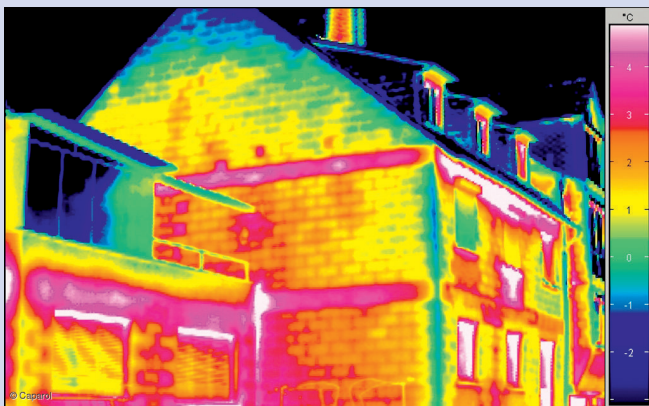
Снимка 1: Местата, от които се губи най-много енергия за отбелязани в червено.
